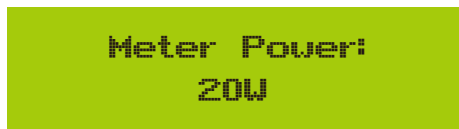
Abb. 7.36 Null-Export-Funktion über Energiezähler einschalten
